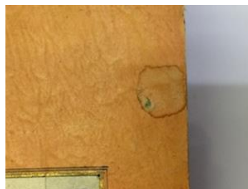
لکه های ناشی از نفوذ رطوبت
