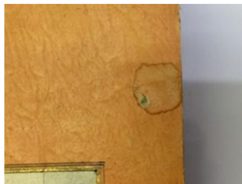
لکه‌های ناشی از نفوذ رطوبت
